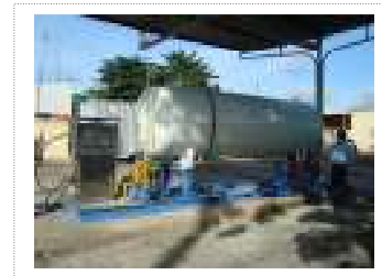
Hình 2 : Trạm Autogas tại CN. Vũng Tàu
