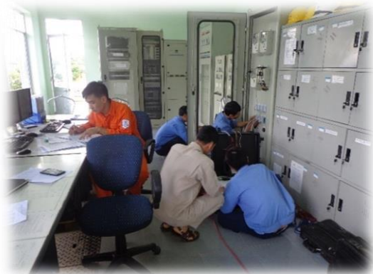
Kiểm định công tơ đo đếm tại NMTĐ Đắk Pône
