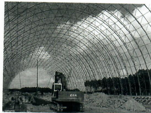
Hình ảnh 6: Kho Tổng hợp Nhà máy xi măng Đồng Lâm – tỉnh Thừa Thiên Huế
