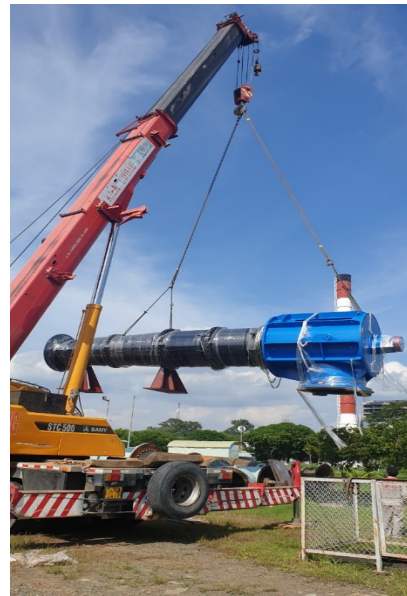
Ảnh: Bơm tuần hoàn – Nhà máy Nhiệt điện Thủ Đức
