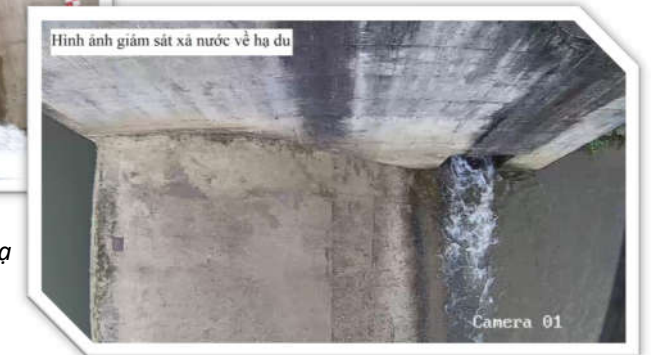
Camera quan sát cửa xả sau hạ lưu đập NMTĐ Đăk Pône
