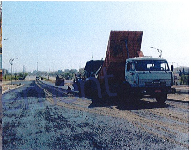
Thi công thảm bê tông nhựa DA Khu đô thị Thủy Tú-Đà Nẵng (EcoCham)
