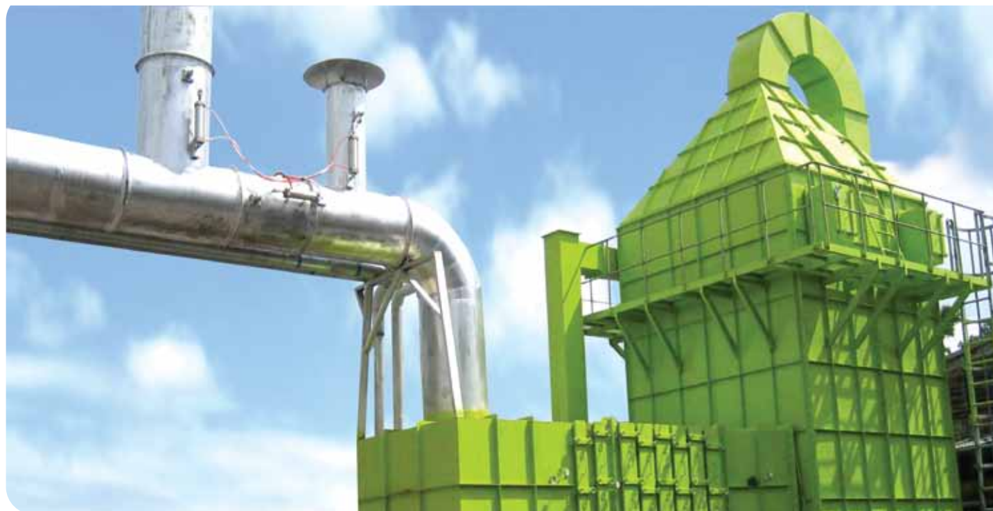
Hệ thống thu hồi khí thải DOP tại máy sản xuất giả da PVC xốp
