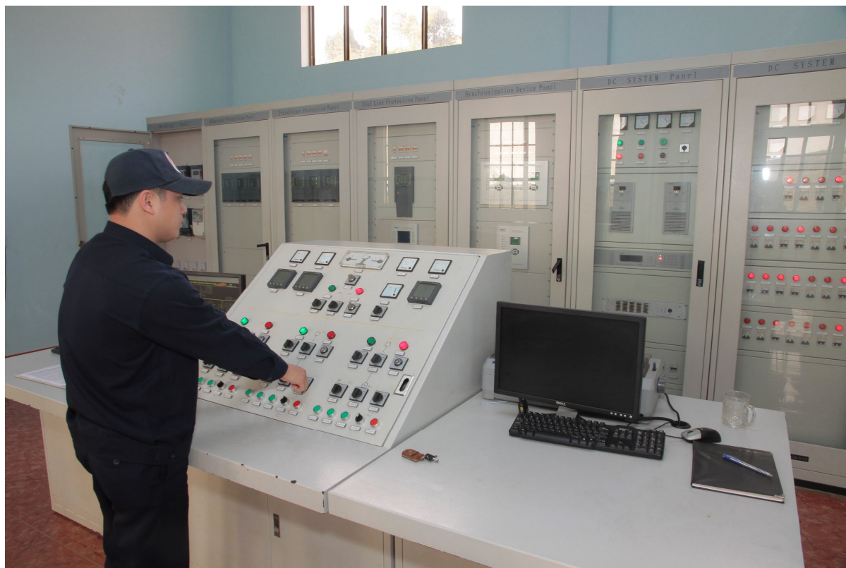
Ảnh: Phòng vận hành Nhà máy IaPuch3 – 6,6 MW, đưa vào hoạt động KD năm 2008
