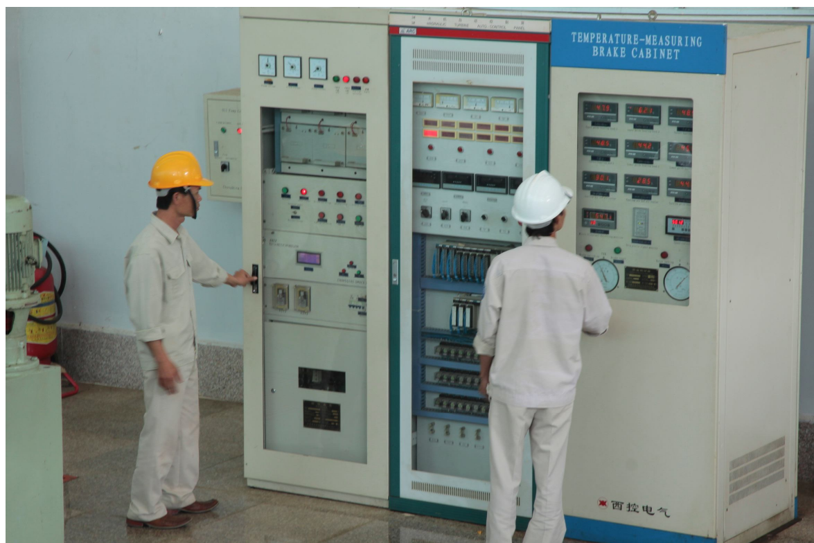
Ảnh: Tủ bảng điện nhà máy thủy điện H'Chan 12MW năm 2006
