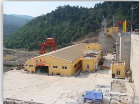
Thủy điện Sông Bung 5 – tháng 4/2013
