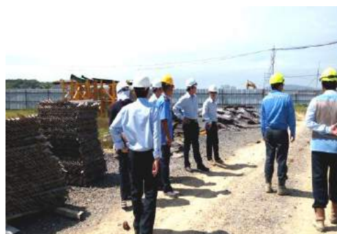
Ban lãnh đạo Công ty kiểm tra ATLĐ tại Công trình Bệnh Viện Đa Khoa Vũng Tàu
