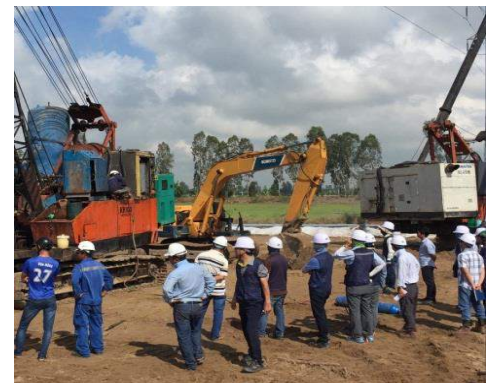
Ban lãnh đạo Công ty kiểm tra tiến độ thi công Công trường đường Cao tốc Lộ Tê - Rạch Sỏi
