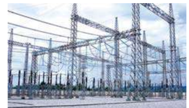
Trạm biến áp Bắc Kạn
