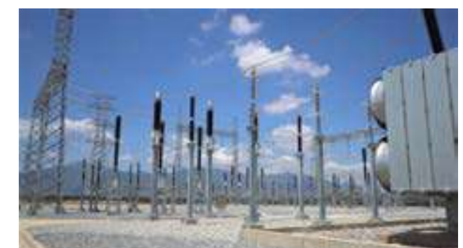
ĐZ 220kV điện mặt trời BIM - Ninh Thuận
