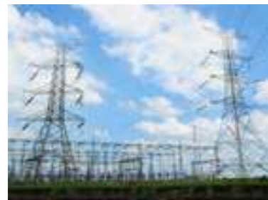
ĐZ 500kV xuất tuyến trạm 500kV Phố Nối - Hưng Yên
