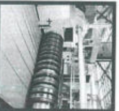
● Hệ Thống Coil Center
