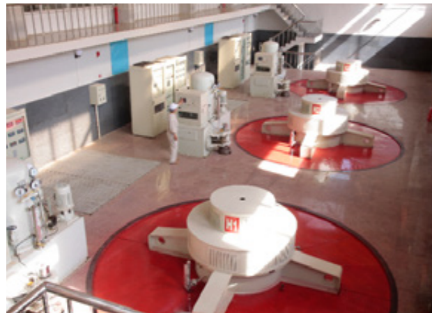
Bên trong Nhà máy Thủy điện Đăk Pi Hao 2 - Gia Lai
