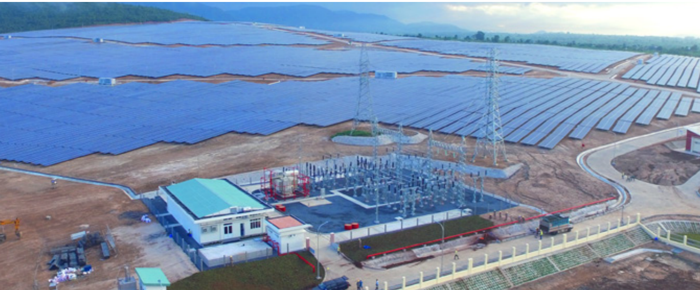
Toàn cảnh Nhà máy Điện Mặt trời TTC Krông Pa - Gia Lai với tổng vốn đầu tư gồm 1.300 tỷ đồng và sản lượng 103 triệu kWh/năm
