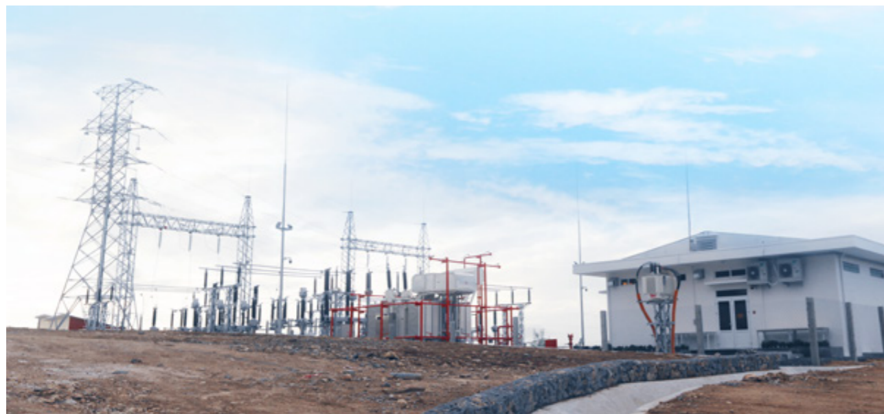
Nhà điều hành Nhà máy Điện Mặt trời Krông Pa - Gia Lai
