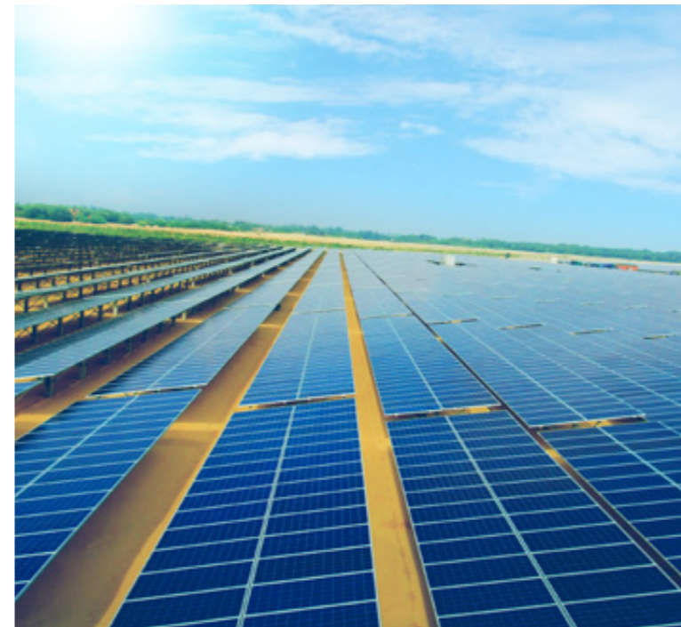
Hệ thống pin Mặt trời tại Nhà máy TTC Phong Điền - Huế
