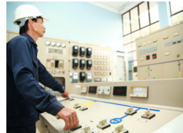
Hệ thống điều khiển phân tán tại Nhà máy Thủy điện Ayun Hạ - Gia Lai
