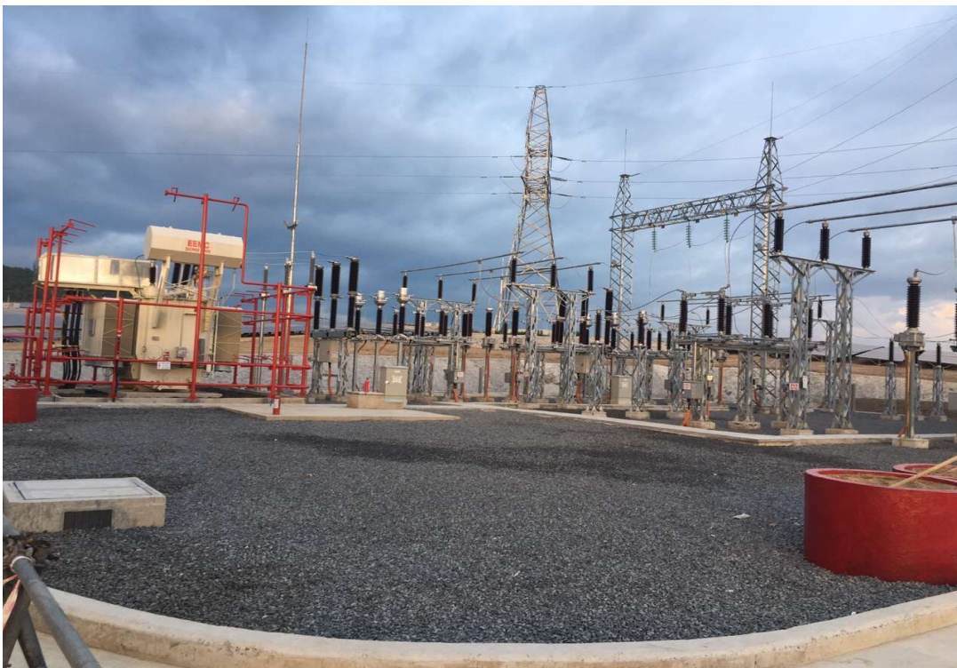
Máy biến áp 63MVA-115/23kV của Tổng Công ty lắp đặt tại Nhà máy Điện mặt trời Krông Pa, tỉnh Gia Lai
