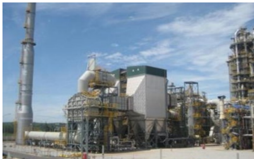
Hệ thống lọc bụi tĩnh điện
