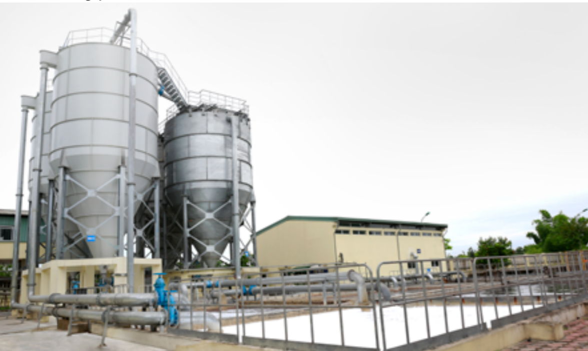
Hệ thống Silo nước tuần hoàn
