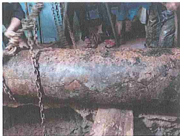
Sự cố vỡ ống D400 tối 20/11/2017 Ngưng hoạt động NMN, hư hỏng nhà dân.
