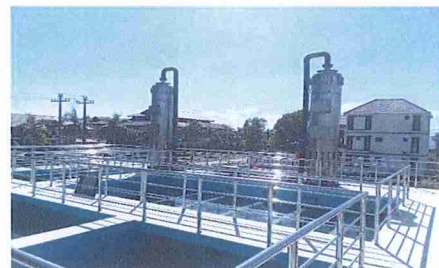
Nâng cấp tạm thời Khu xử lý Phú Bài; Bổ cấp nước ngầm vào mùa đông, dự phòng cấp nước mùa khô hạn (T07)
