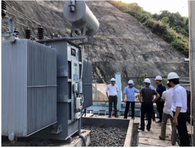
Đoàn Thanh tra Cục Kỹ thuật an toàn và Môi trường công nghiệp - Bộ Công Thương làm việc tại NMTĐ Đa Krông 1
