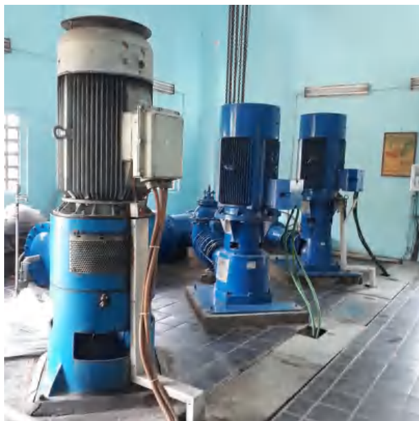
Hình 1: Hệ thống bơm nước sạch của Công ty Cổ phần Cấp thoát nước Cần Thơ
