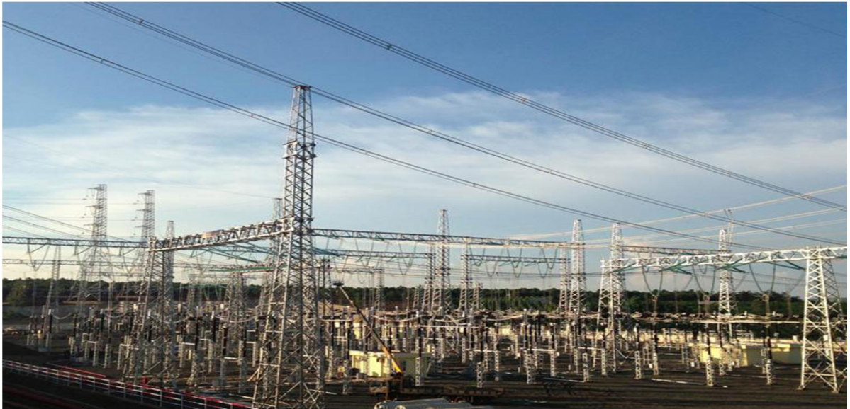
Trạm biến áp 500kV Pleiku
