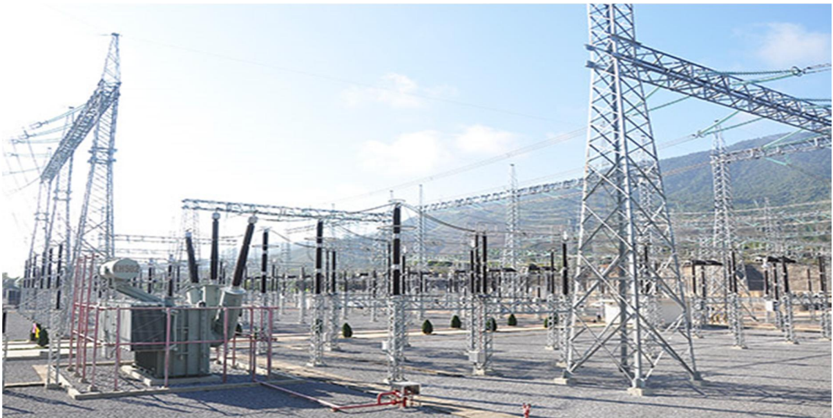
Trạm biến áp 500kV Sơn La
