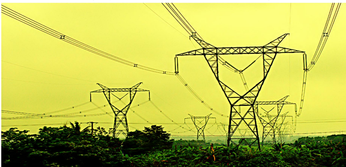
Đường dây 500kV Bắc – Nam (mạch 1)
