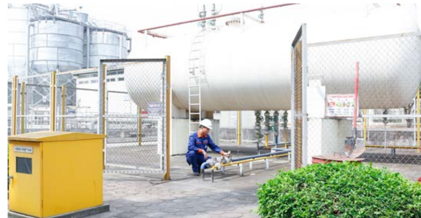
Trạm cấp gas của công ty Vicostone
