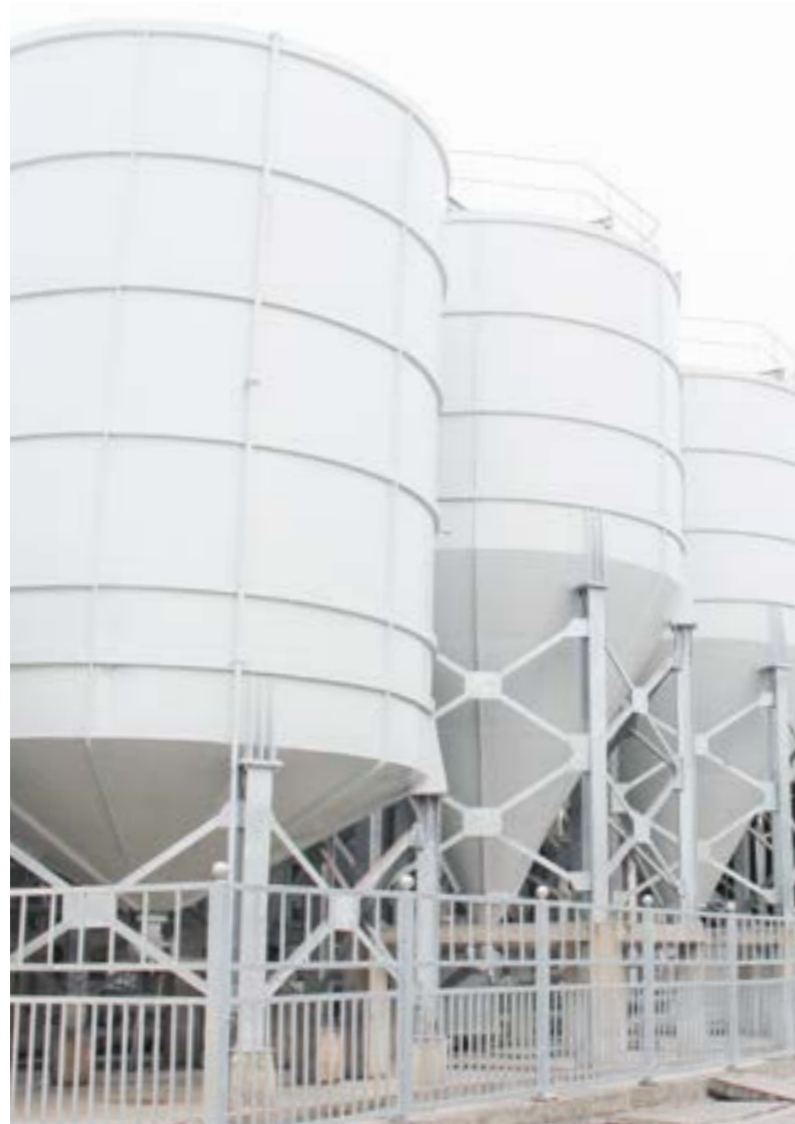
Hệ thống Silo nước tuần hoàn
