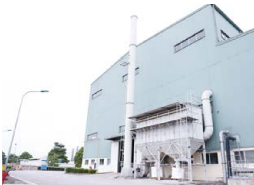
Hệ thống xử lý bụi trong nhà máy
