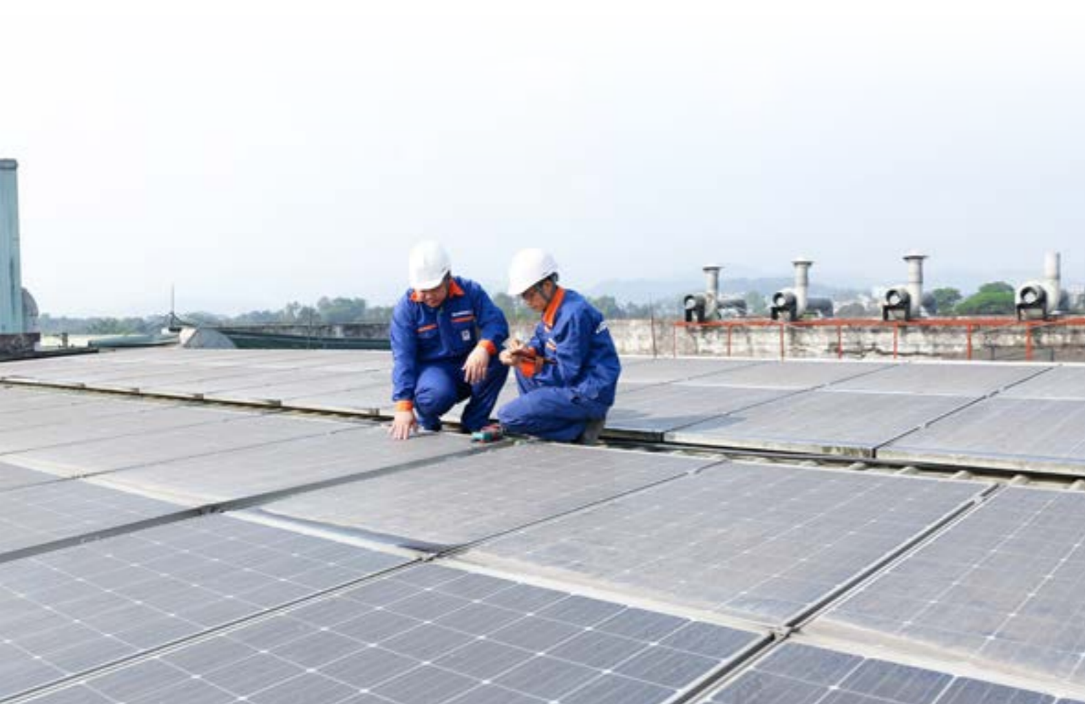
Hệ thống pin năng lượng mặt trời
