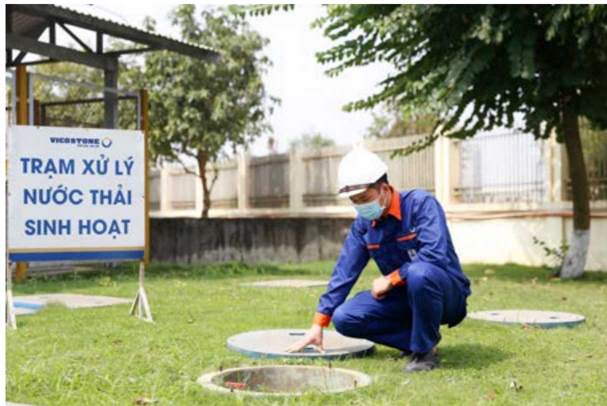
Trạm xử lý nước thải sinh hoạt
