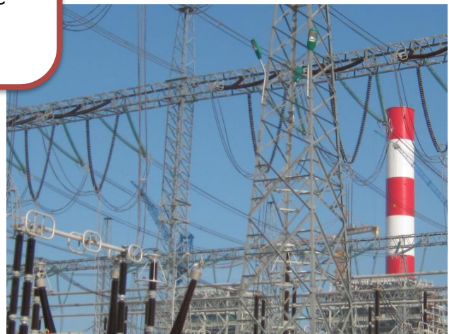
Trạm biến áp 500kV Vĩnh Tân
