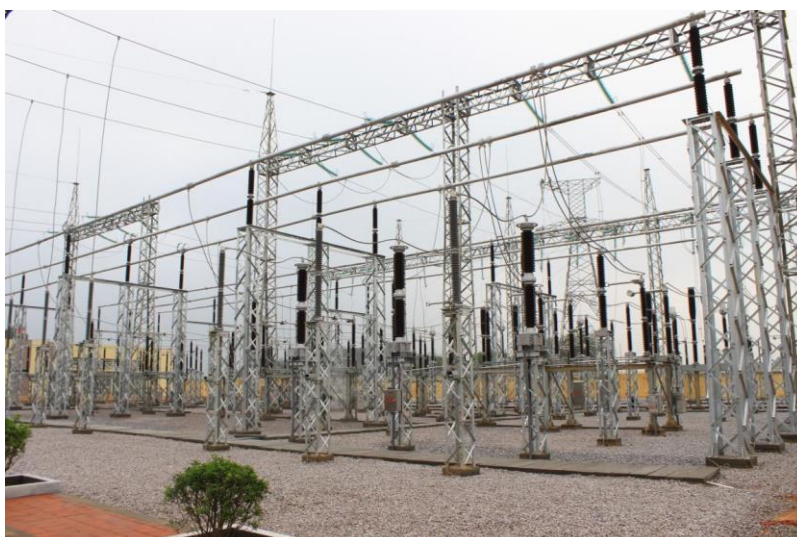
TBA 500kV Việt Trì
