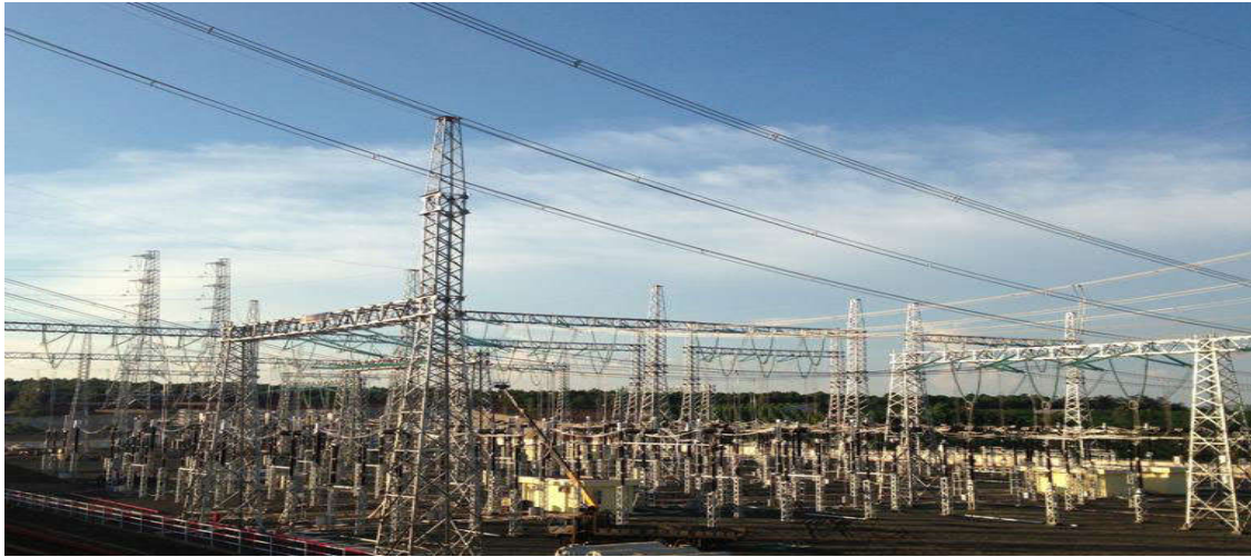
Trạm biến áp 500kV Pleiku
