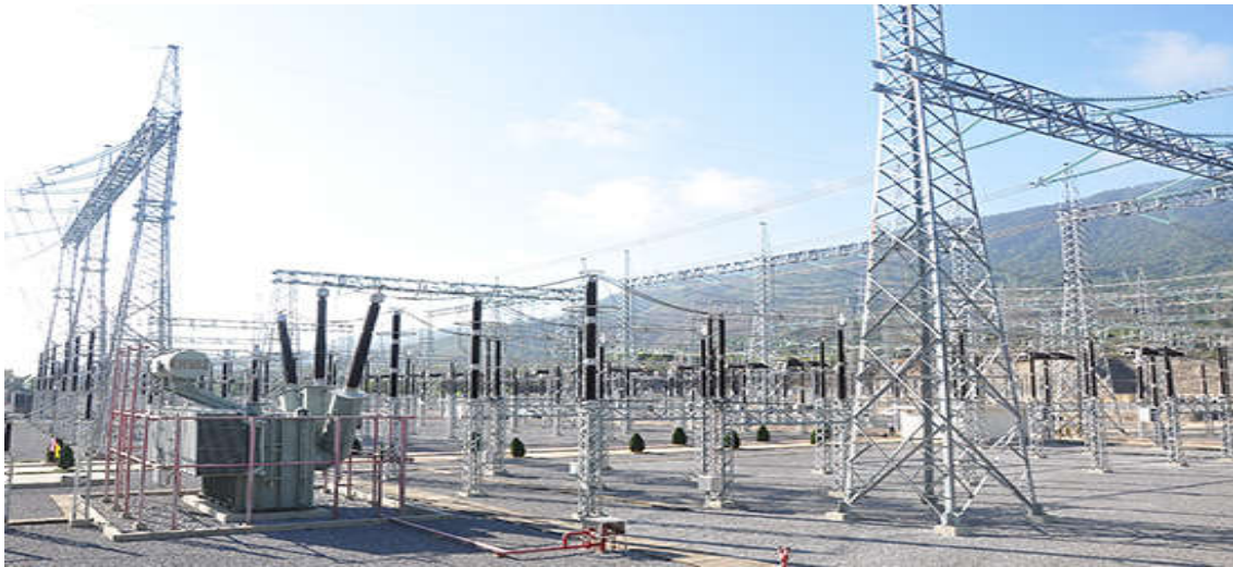
Trạm biến áp 500kV Sơn La
