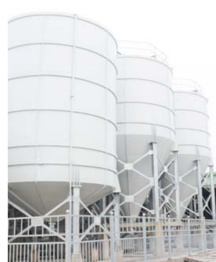
Hệ thống Silo nước tuần hoàn tại nhà máy Vicostone
