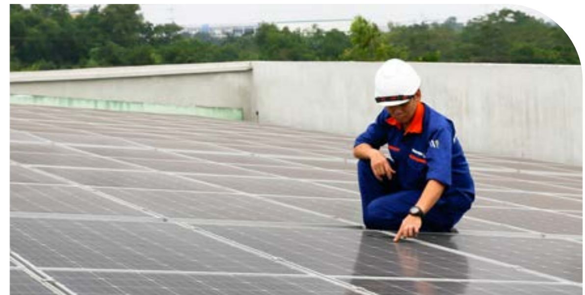
Nhân viên kỹ thuật định kỳ kiểm tra tấm năng lượng mặt trời trên nóc nhà điều hành của Công ty
