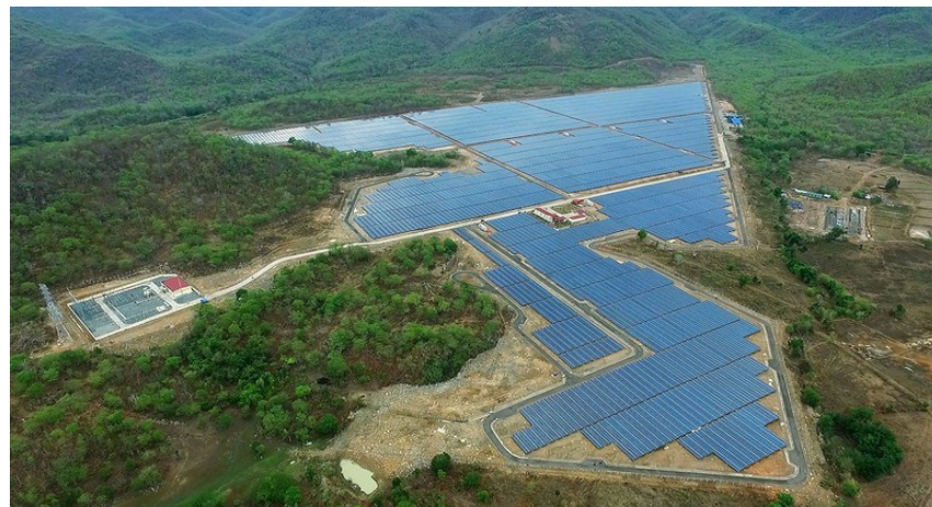
Hình 8: Dự án Điện Mặt trời TTC Hàm Phú 2
