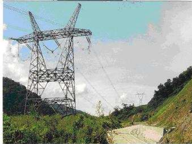
Đường dây 500kV Bắc – Nam (Mạch 1) Đoạn Đà Nẵng – Buôn Mê Thuột
