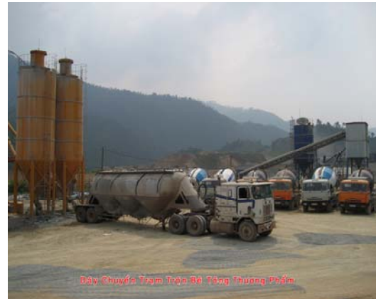
Dây chuyền trạm trộn bê tông DSM
