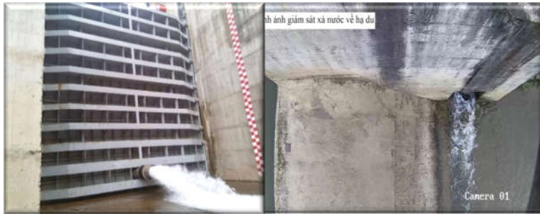
Đảm bảo dòng môi trường cho hạ lưu đập NMTĐ Đa Krông 1
