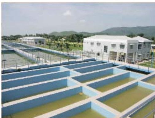
Nhà máy nước Hồ Đá Đen (Bà Rịa - Vũng Tàu)
