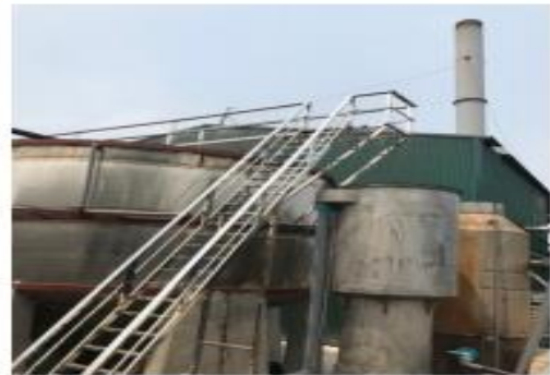
Hệ thống xử lý nước thải và nổi hơi
