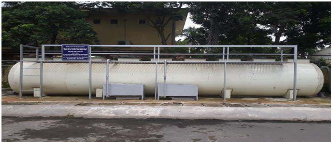
Hình ảnh: Hệ thống xử lý nước thải công suất 30 m 3 /ngày.đêm tại 3 nhà máy thức ăn chăn nuôi KCN Khắc Niệm
