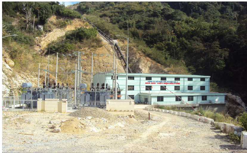
Toàn cảnh Nhà máy thủy điện Đăk Pône
