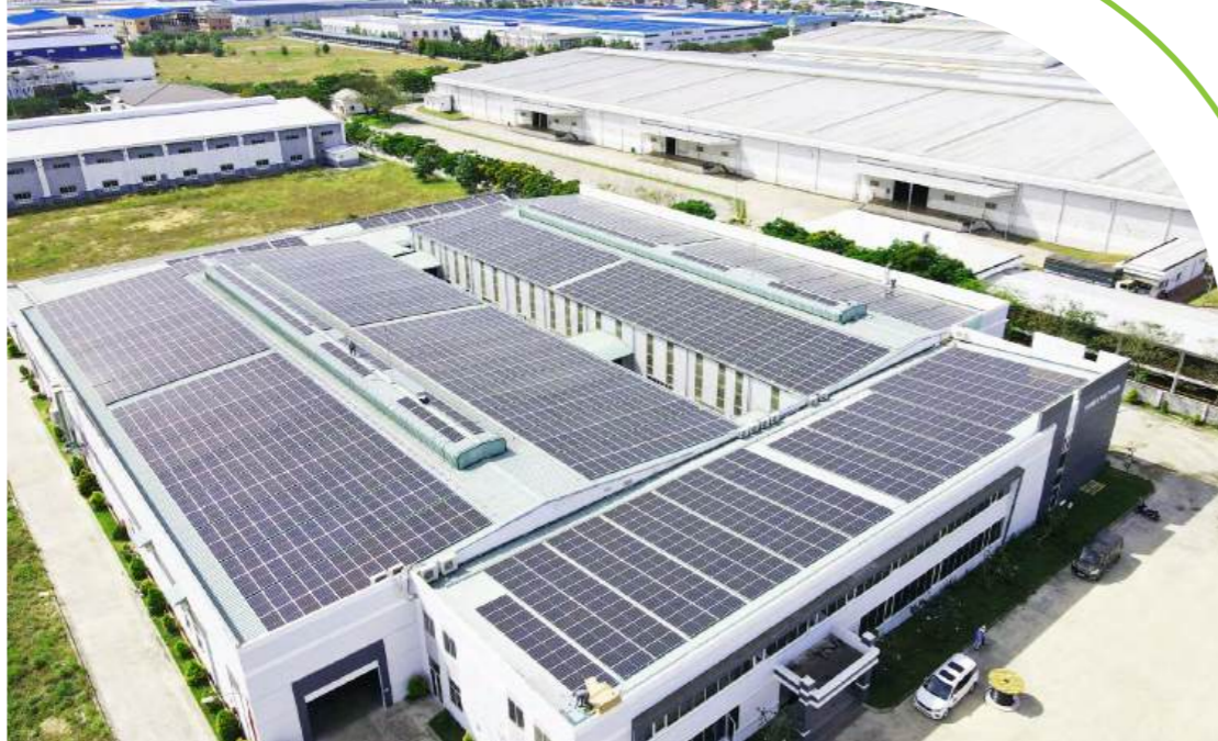
Hệ thống điện mặt trời áp mái Sonny
