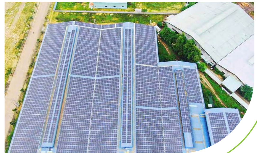
Hệ thống điện mặt trời áp mái Kinh Bắc
