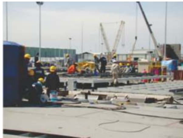
Công nhân PVSb thi công chế tạo và lắp đặt các công trình cơ khí dầu khí đảm bảo an toàn
