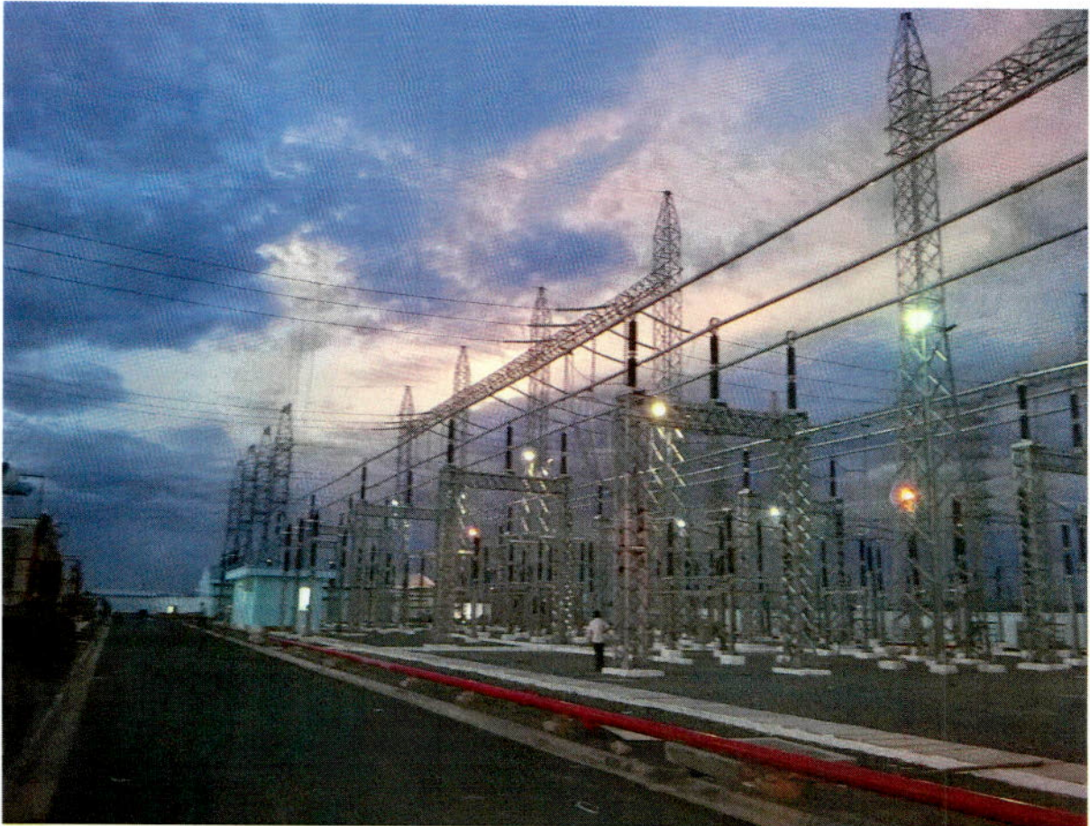
Trạm biến áp 220KV – Phú Mỹ
