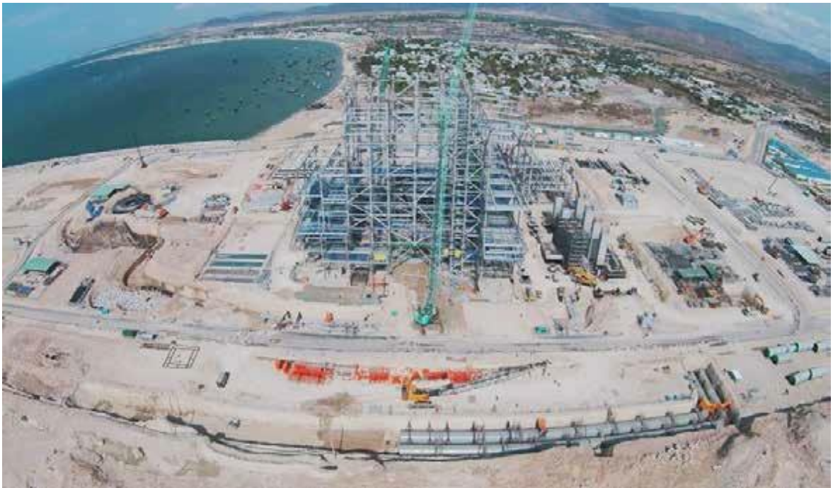
Toàn cảnh Vinh Tân 4, khu vực Nhà máy chính đang thi công, TV2 là thành viên của Tổ hợp nhà thầu EPC
