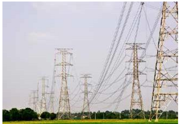
Đường dây 500kV Pleiku – Mỹ Phước – Cầu Bông
