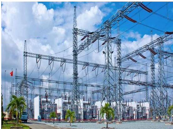
Trạm biến áp 500 KV Nhà Bè
