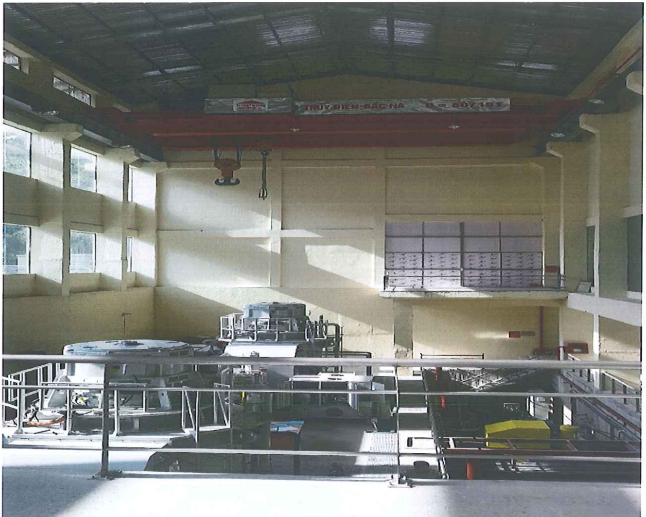
Nhà máy thủy điện Bắc Nà - Nguồn: CTCP Sông Đà 505
