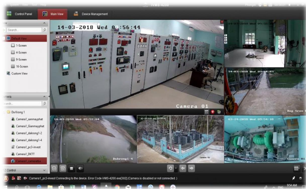
Hình ảnh tại NMTĐ Đa Krông 1 quan sát qua hệ thống camera
