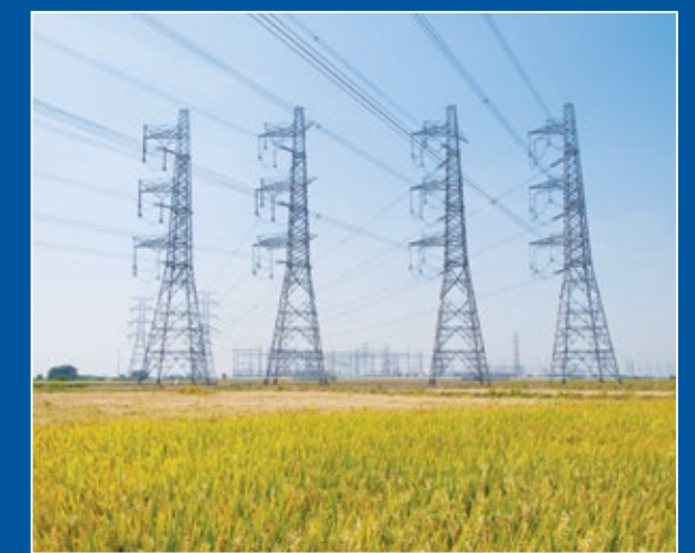
Đường dây 500kV Pleiku - Mỹ Phước - Cầu Bông
