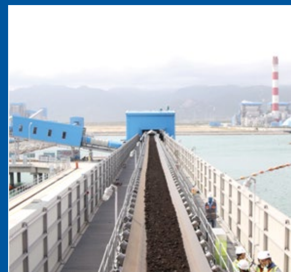
Hệ thống băng tải than từ cảng than và kho than, Nhà Máy Nhiệt điện Vĩnh Tân
