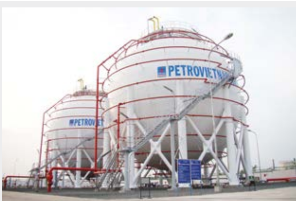
Kho LPG Gò Dầu, Đồng Nai (dung tích 4.000 MT) cung cấp LPG rời cho khu vực Đông Nam Bộ.
