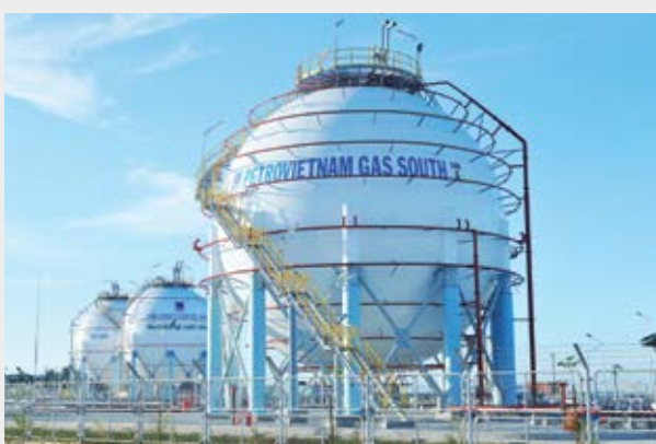
Kho LPG tại Dung Quất, lấy hàng trực tiếp từ Nhà máy lọc dầu Dung Quất, cung cấp ở khu vực miền Trung.
