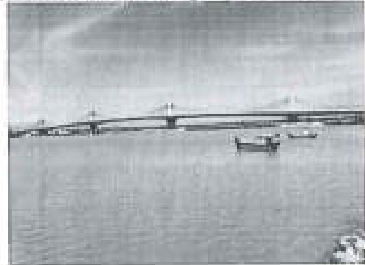
Thi công cầu dây văng An Đông, tỉnh Ninh Thuận Construction of cable-stayed An Dong Bridge, Ninh Thuan Province
