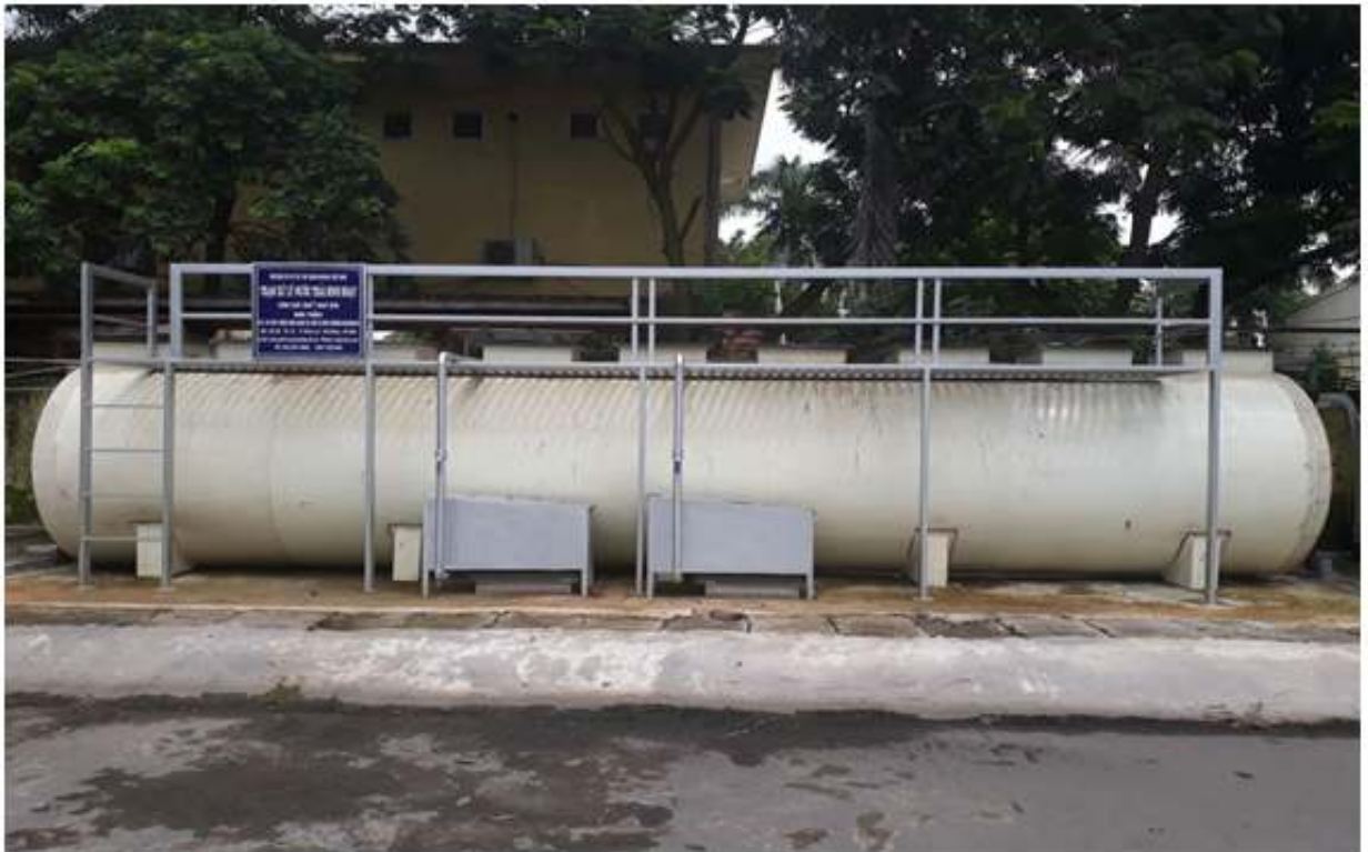
Hình ảnh: Hệ thống xử lý nước thải công suất 30 m 3 /ngày.đêm tại 3 nhà máy thức ăn chăn nuôi KCN Khắc Niệm
