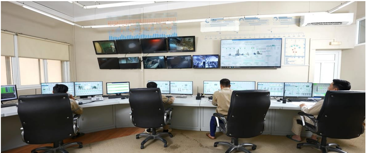
CẢI TẠO NÂNG CẤP HỆ THỐNG ĐIỀU KHIỂN TRUNG TÂM DCS ĐI VÀO HOẠT ĐỘNG
