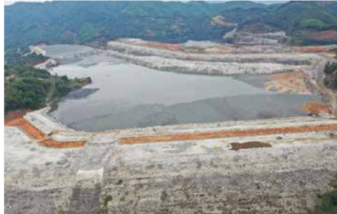
Một góc khu vực Đập chứa đuôi quặng tại mỏ Núi Pháo, Việt Nam
