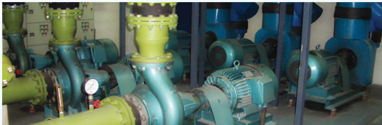
Lắp đặt bộ biến tần ở máy bơm nước làm mát
