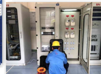
Thực hiện cài đặt dịch chuyển giờ phát điện cao điểm tại hệ thống công tơ đo đếm
