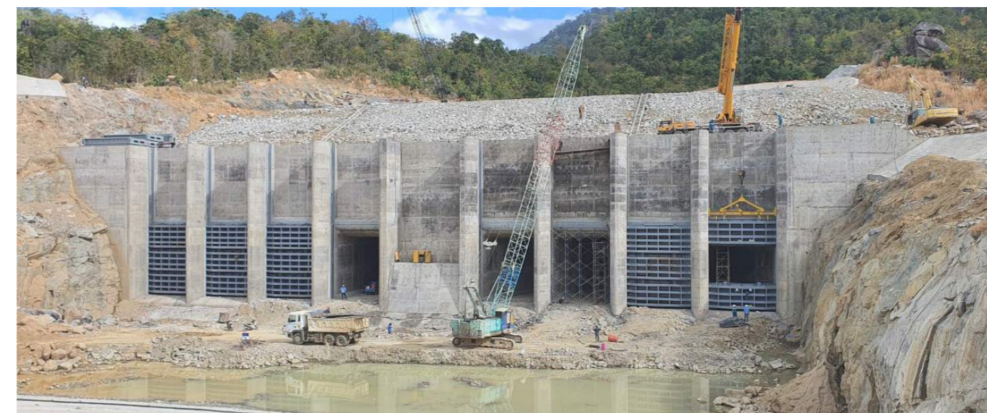
Công trình Thủy điện Tích năng Bác Ái - tỉnh Ninh Thuận
