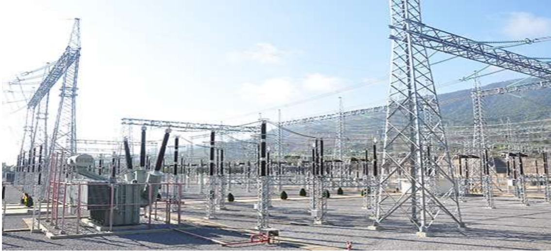
Trạm biến áp 500kV Sơn La
