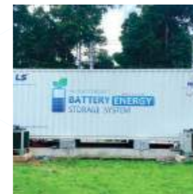
Hệ thống lưu trữ BESS tại tòa nhà PECC2 Innovation Hub
