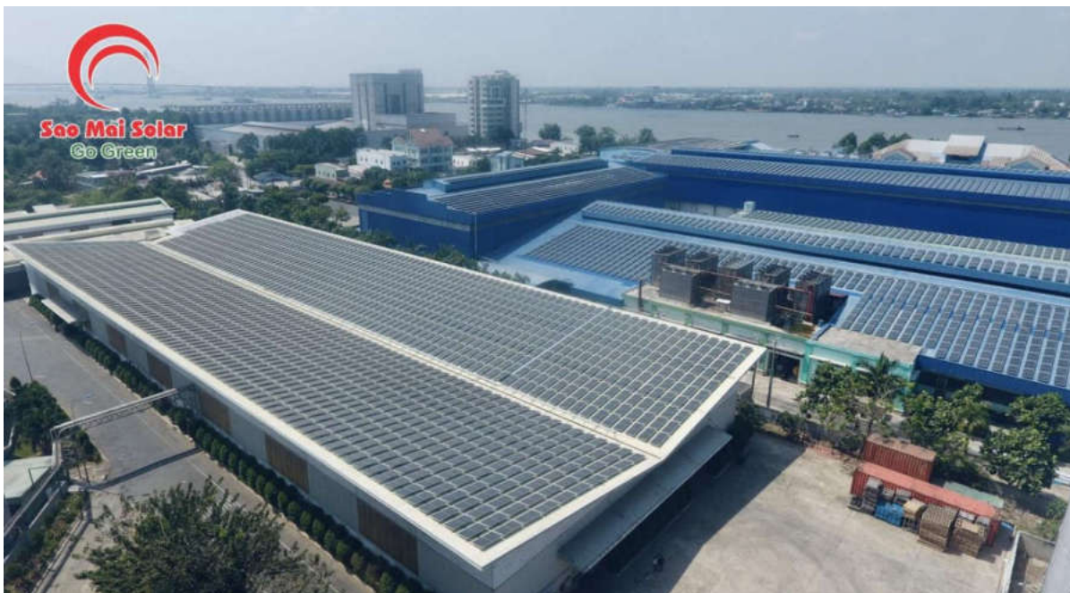
Hệ thống Pin năng lượng mặt trời được lắp đặt trên nóc các Nhà máy của Cụm công nghiệp
